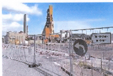
Das Baugelände für das Biomasse-Kraftwerk ist abgeräumt, der Baustart steht bevor - und die Klage gegen das Projekt auch.
